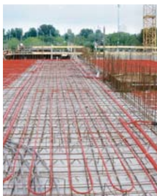
Riscaldamento e raffreddamento efficienti con la geotermia e la termoregolazione delle masse di cemento
